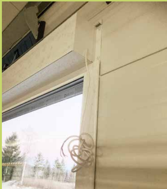
Rullgardinkasse sett frå innsida montert i sandwichelementvindu med renoveringsprofil.
